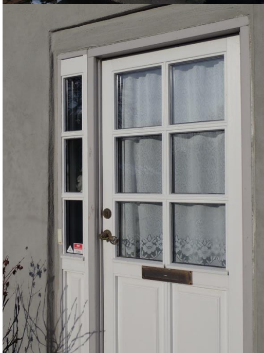
Eksempler på nye døre i det gamle Rudkøbing, som ikke passer til byggeskikken fra 1800-tallet.
